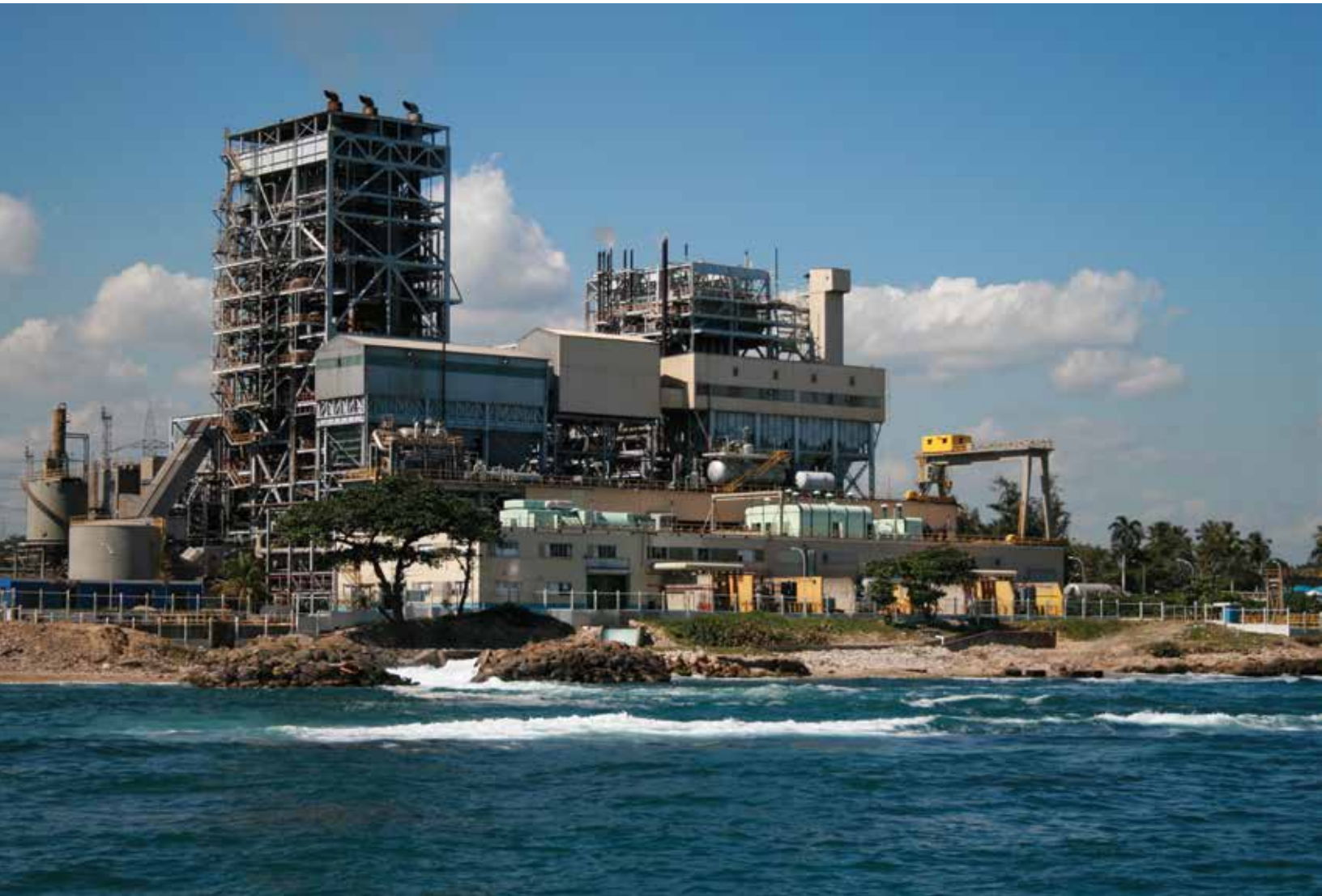
Unidad generadora de Electricidad Itabo I.
