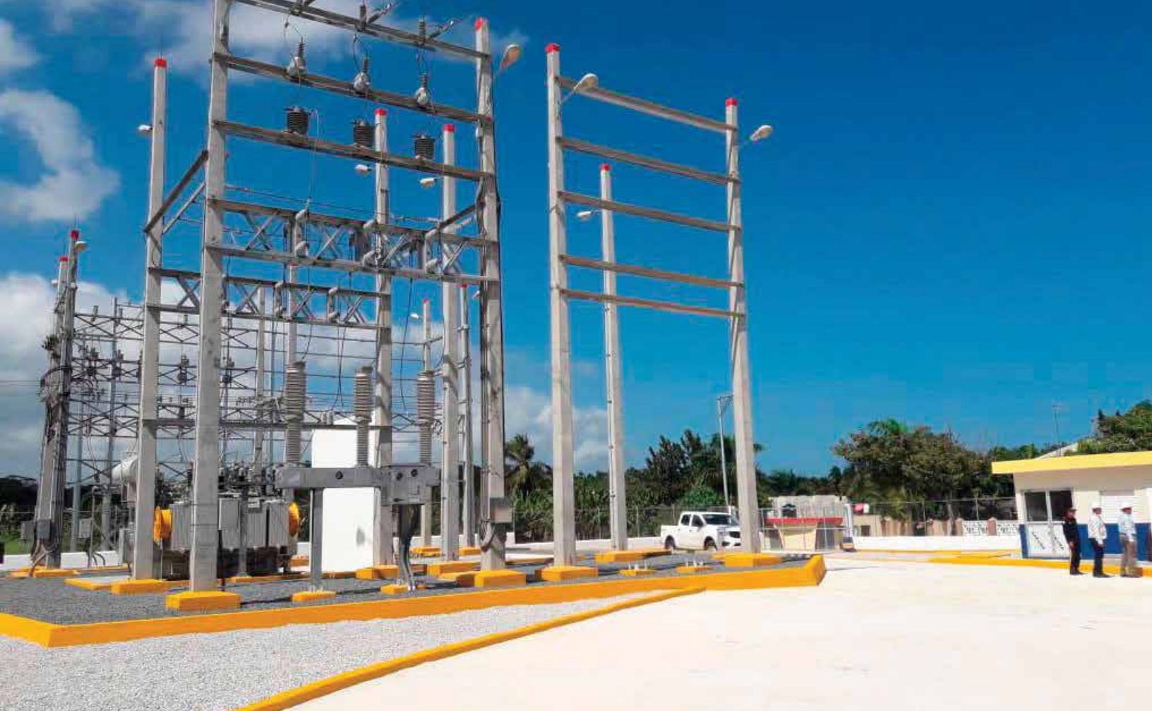
Subestación eléctrica Nisibón, operada por EDEESTE
